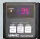
Digitale Überwachung Batterieladestatus
